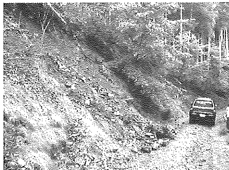
小規模な土砂崩れ／大規模な土砂崩れ(右下) いずれも東京都奥多摩
