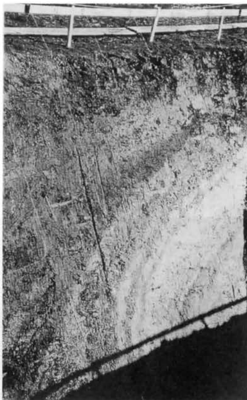
写真1 白馬村堀之内の活断層発掘 地質調査所1995年11月 平林照雄 撮影 1995.11.5 湾曲している下に東へ緩斜向した逆断層があり、断層は地下では意外な変形をしていることがある
