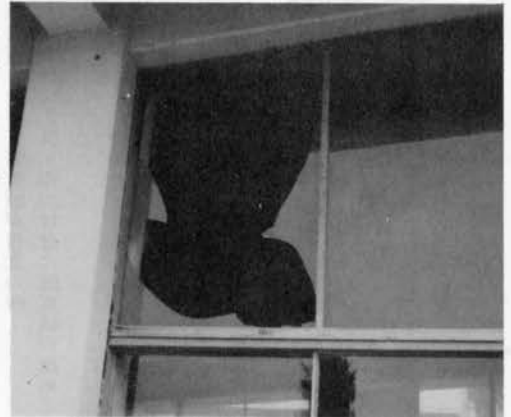
写真2 割れた窓ガラス(大町市仁科台中学校)
