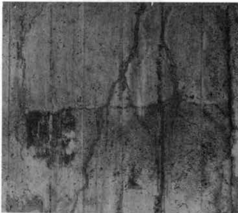
写真1 割れ目ができた煙突基部(池田・松川清掃組合)
